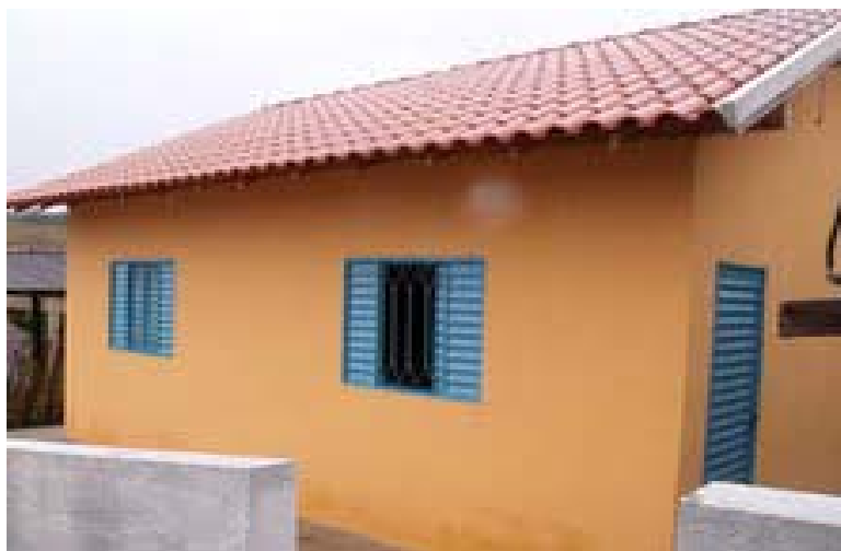
A casa foi erguida no lugar da antiga, que havia sido interditada pela Defesa Civil por alto risco de desabamento
