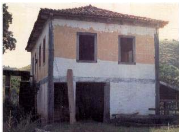
Antigo prédio da Fazenda Boa Sorte, uma sólida construção. Foto do CEPEC obtida em 1991.
